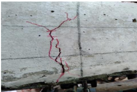
Gambar 16 Retak pada tengah bentang [2]
