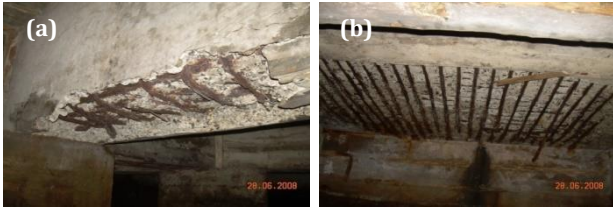
Gambar 1 Contoh kerusakan pada elemen struktur beton: (a) balok, dan (b) pelat
