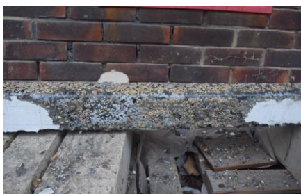
Gambar 15 Sisi bawah balok setelah dibongkar
