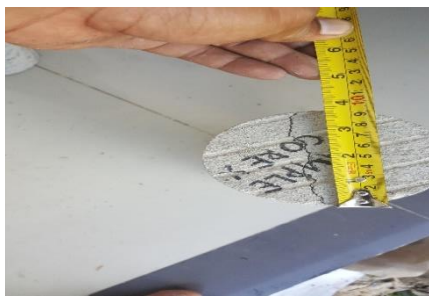
Gambar 2 Pengukuran lebar retak
