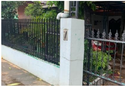
Gambar 16 Retakan pada rumah penduduk
